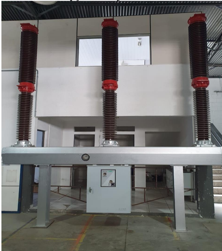
Laboratório de Disjuntores de Alta Tensão
